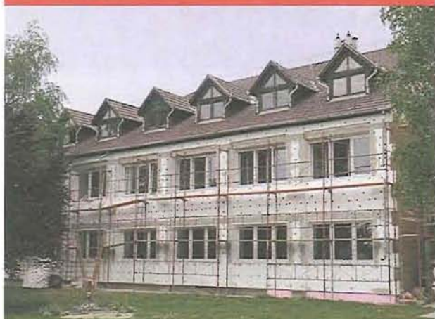
A nyílászárók cseréje után az épület külső hőszigetelését végzik a Selyem úti városháza épületén
