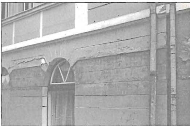
Az endrődi Közösségi Ház utcafrontja jelenleg (részlet) ami megérett a felújításra
